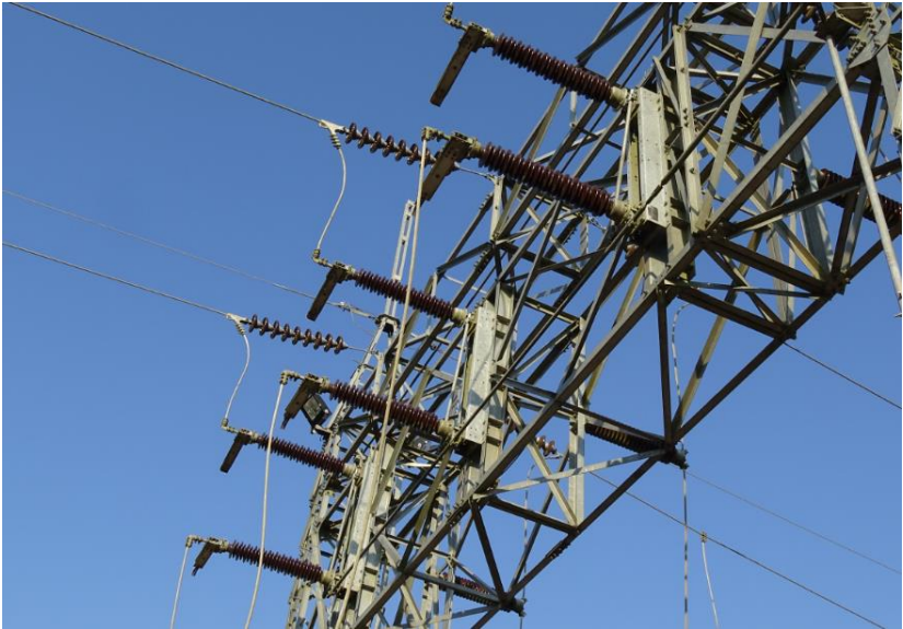
Equipo instalado en S/E San Ignacio de Moxos
