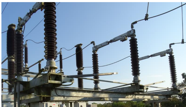
Equipo instalado en S/E Trinidad
