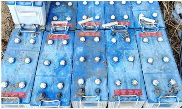
8 BATERÍAS PROVENIENTES DE RECONECTADORES Y OTROS.
